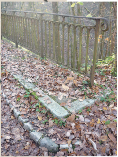
Détail de mise en oeuvre pont du Pipeu : garde-corps et trottoir pavé
